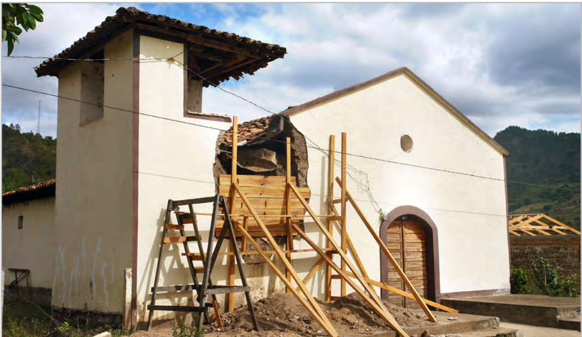
La iglesia San José de Mangulile, es un edificio de reciente construcción y los daños que presenta en su fachada principal, se deben a las tormentas de octubre del año 2008, ahora los habitantes realizan gestiones para su reconstrucción.
